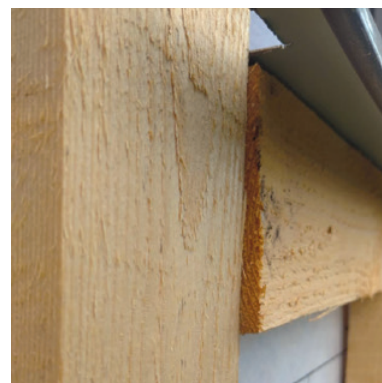
Обрешетка не в плоскости. Перекрыт вентиляционный канал.
